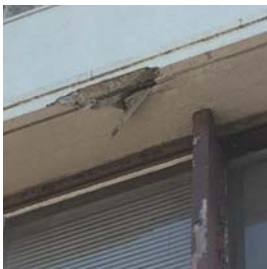
剥がれた部分
