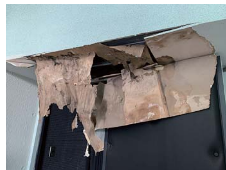
プラネタリウム入口は 雨漏りの影響が
